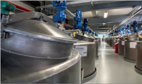
Abb. 3: Die Produktionshalle mit Farben- und Lack- tanks bei Bergolin.
